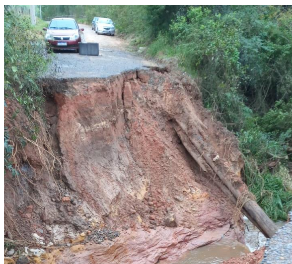
Foto 3 - Impacto das chuvas e cheias extremas nas estradas de acesso aos assentamentos em Capela de Santana
