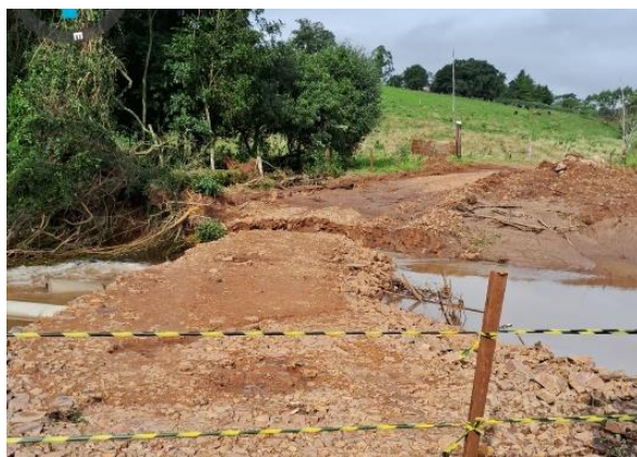
Foto 63 - Ponte danificada no acesso aos assentamentos em Jóia
