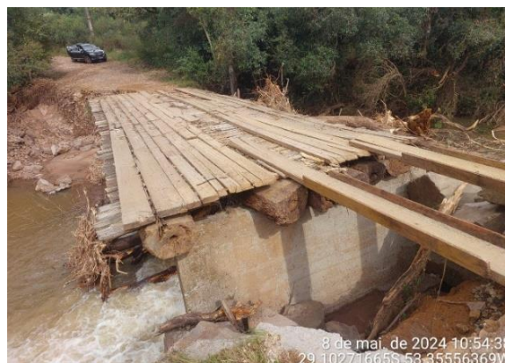
Foto 2 - Ponte destruída no acesso aos assentamentos em Salto do Jacuí
