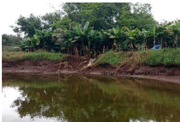
Foto 40 - Açude(piscicultura) com talude rompido da família Dietrich, Linha Buricá
