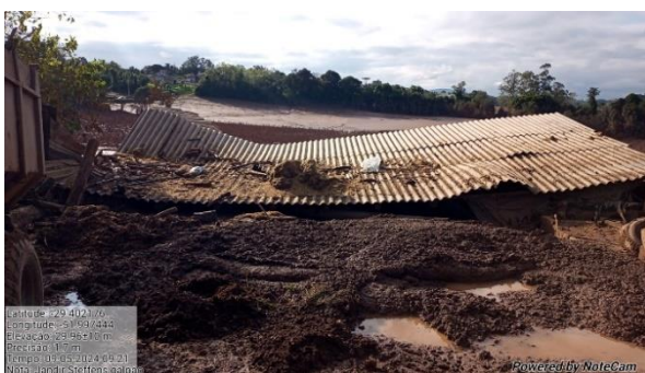
Foto 5 - Destrução total de sala de ordenha e galão em propriedade afetada em Arroio do Meio
