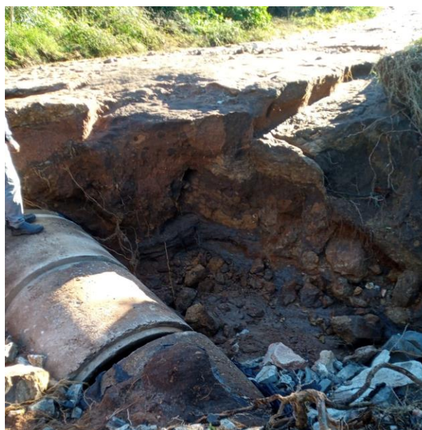
Foto 78 - Diversos acessos intransitáveis em Arroio Grande
