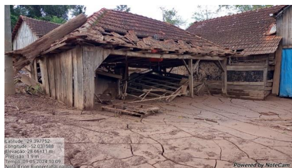
Foto 6 - Galão soterrado em Arroio do Meio
