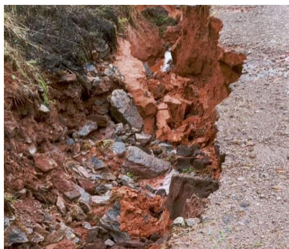
Foto 66 - Estradas danificadas em Salto do Jacuí
