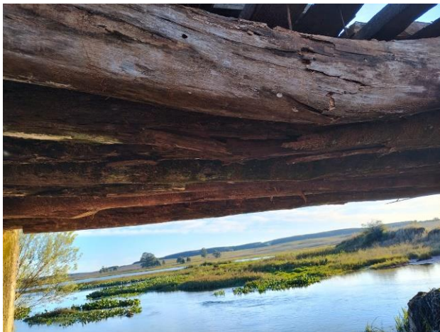
Foto 49 - Estrutura de ponte danificada no acesso aos assentamentos em Santana do Livramento
