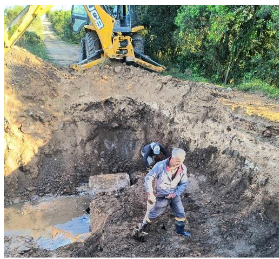
Foto 4 - Acesso aos assentamentos destruídos em Arroio Grande
