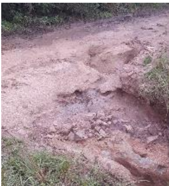
Foto 77 - Danos nas estradas em Arroio Grande
